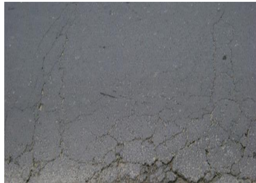
Rys. 3. Uszkodzenia nawierzchni w efekcie starzenia asfaltu
